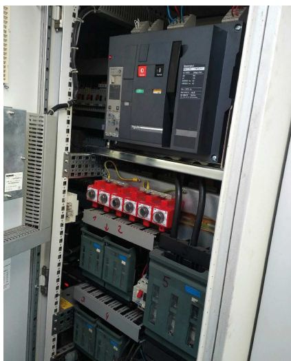
Steuerschrank mit Leistungsschalter und Sicherungen
