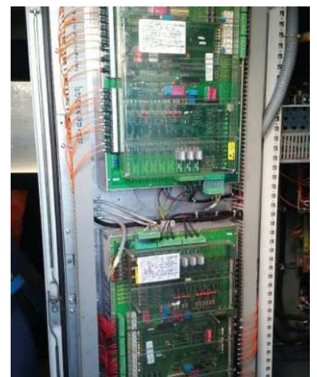
Steuerschrank mit HU-Steuerrack und SU-Steuerrack
