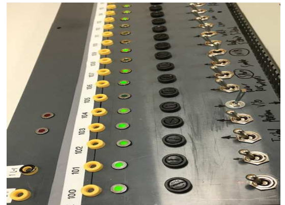
Schaltbare Eingänge zur Fehlersuche
